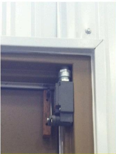
PERSONNEL DOOR INTERLOCKS
